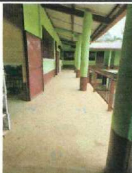
Foto 1: La puerta que requiere reparacion.
