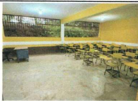
Foto 2: las dos ventanales que se requiere instalacion de ventana para laboratorio de ciencias.
